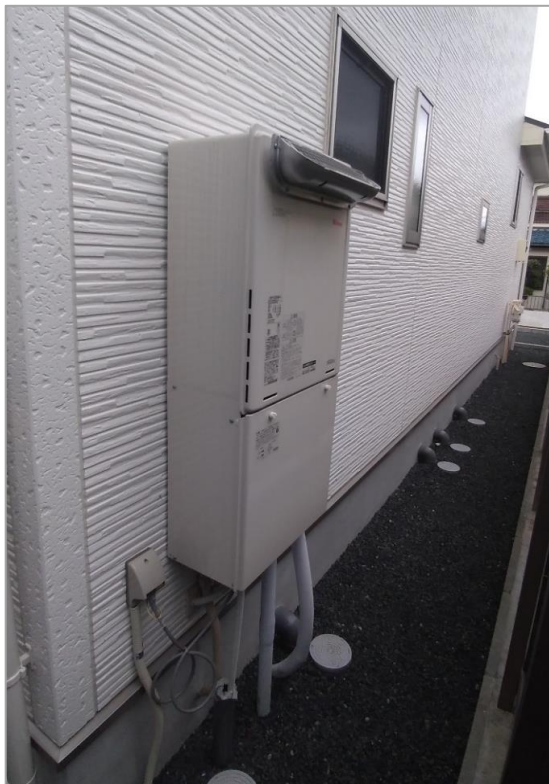
① 給湯器全体
