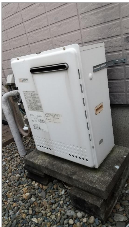
① 給湯器全体
